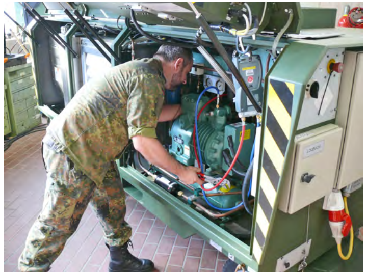
Klimaanlagen verschiedenster Bauart werden weltweit zertifiziert gewartet.
